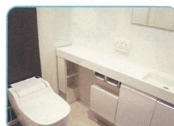
トイレ・洗面所・風呂場 シンク・排水溝
